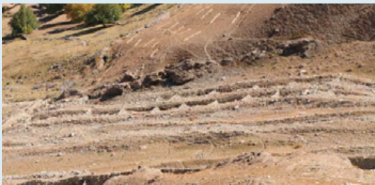
Barrages de retenue, digues de terre et plantations d'arbres visant à stabiliser les pentes
